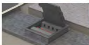
Caixas para tomadas
